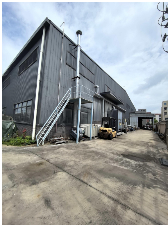
固化废气处理装置及排放口采样平台
