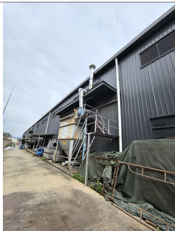
喷粉粉尘废气处理设施及采样平台
