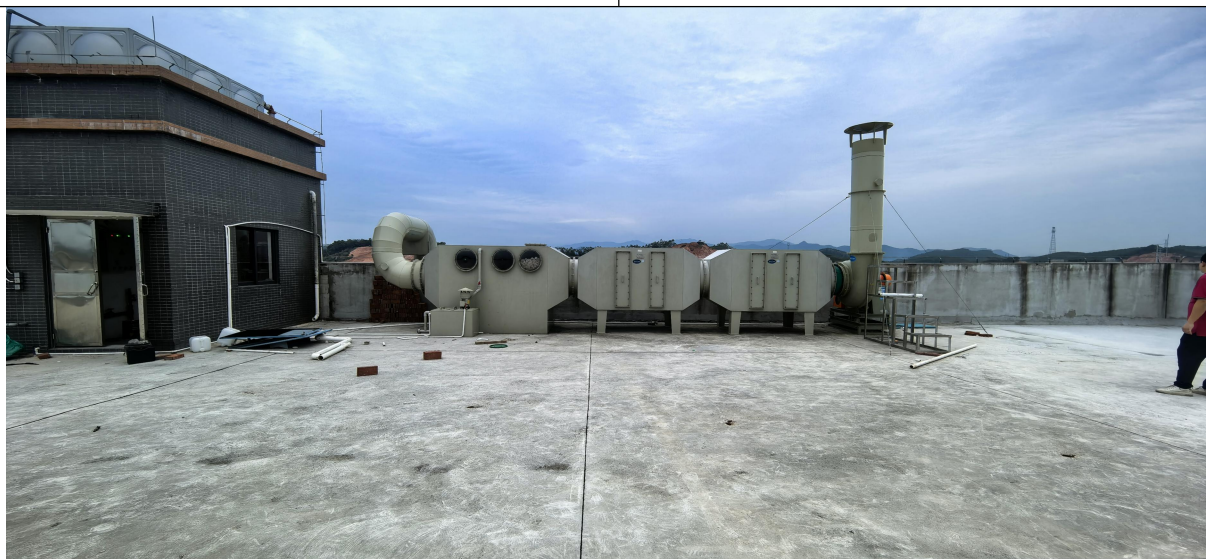
废气处理设施
