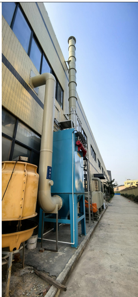
废气处理设施
