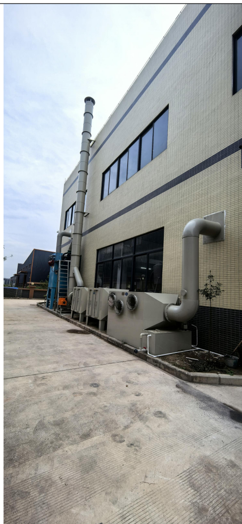
废气处理设施
