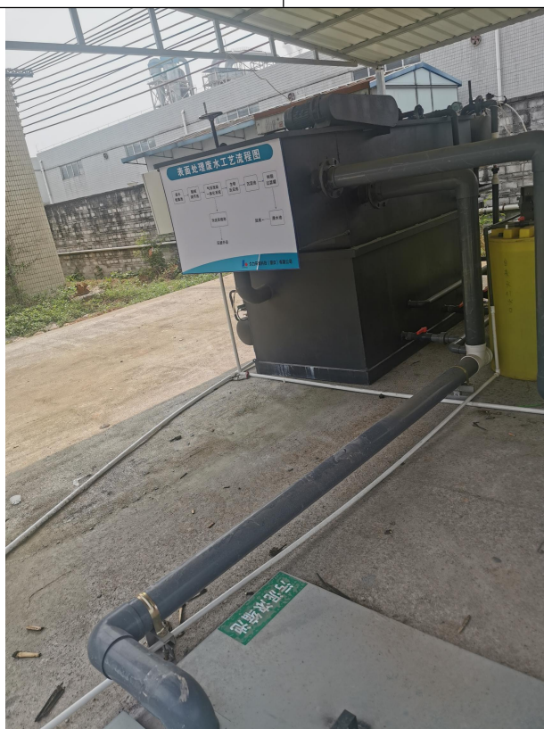
生产废水处理设施
