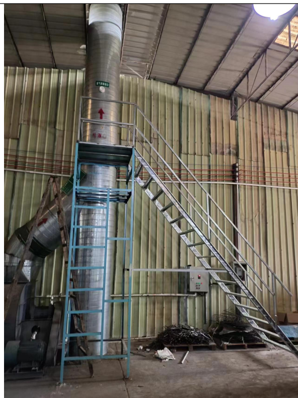
废气排放口采样平台
