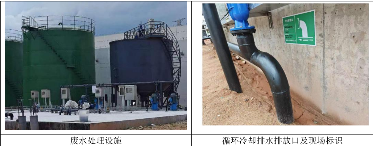
图3-3 废水治理措施现场图片
