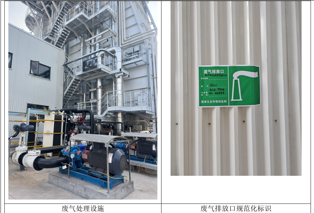
图 3-2 废气治理措施现场图片
