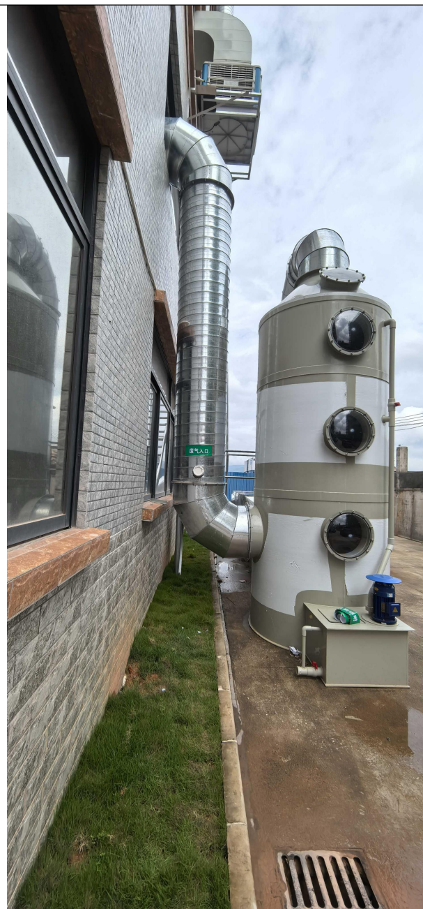
废气处理设施
