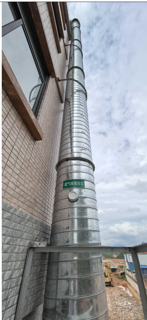
废气排放口采样平台
